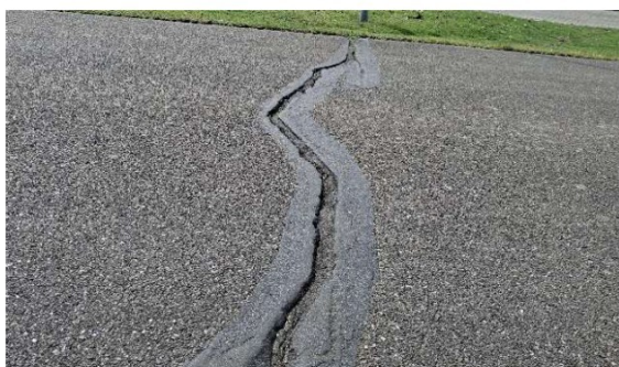
S: Diverse scheuren in asfalt
